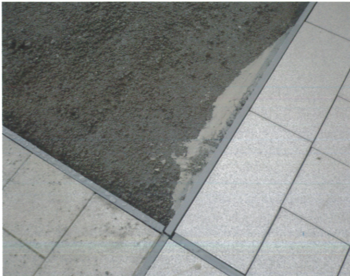
Bei der Sanierungsmaßnahme kam ein speziell entwickelter Bettungsmörtel der Firma Contec International zum Einsatz.
